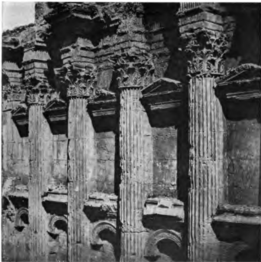
Fig. 31. — Vue intérieure du temple de Jupiter à Baalbek. Ordonnance corinthienne. Emploi de monolithes pour les frontons des niches.
